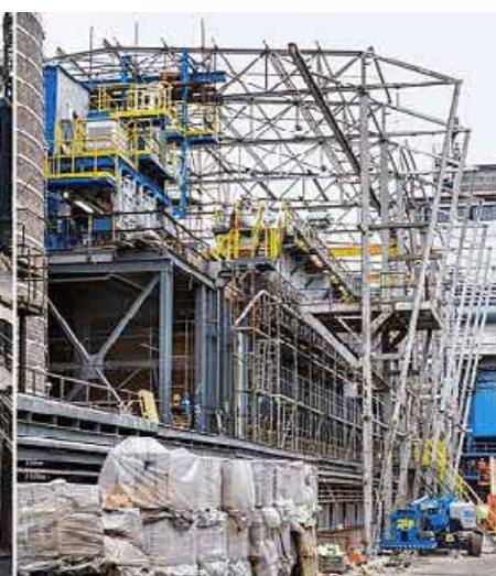
Třinecké železářny - Oprava a modernizace KB 11/ Revamping of Coke Oven Battery no. 11
